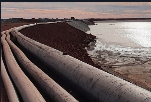
Transporte de agua / relaves
